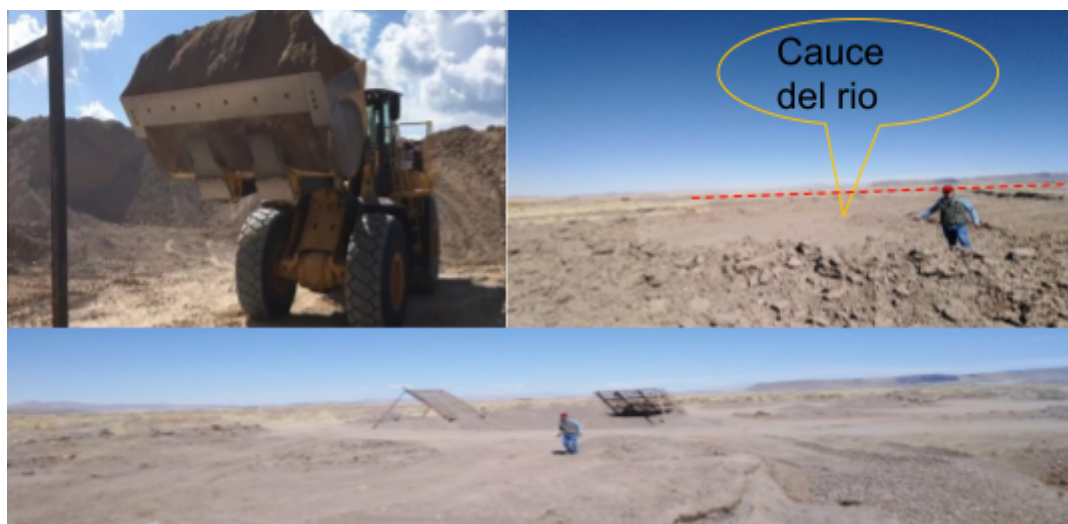
Figura 33:Extracción de arena fuera del cauce de la quebrada Sallagueña
