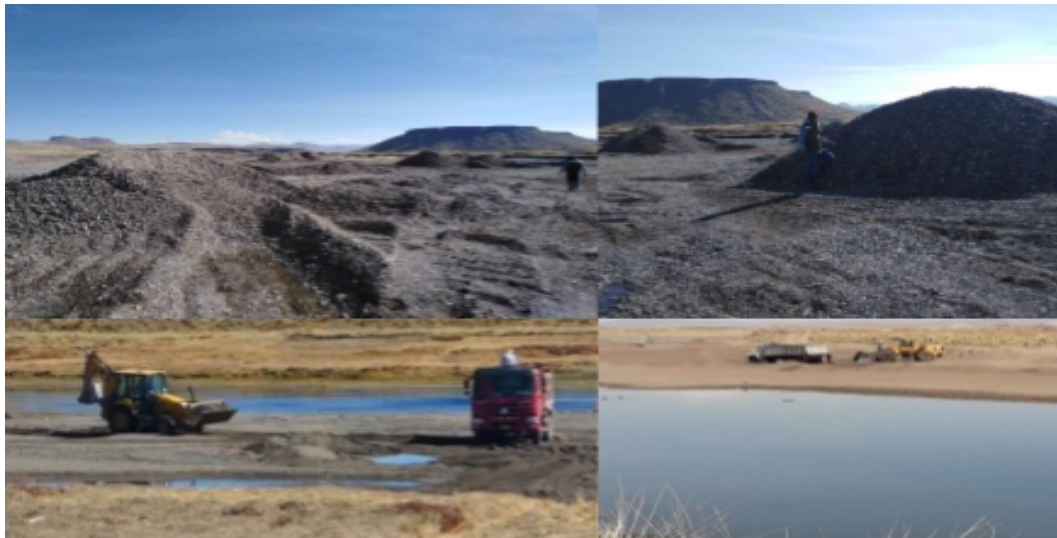
Figura 31: Extracción de arena en el cauce de la quebrada Sallagueña
